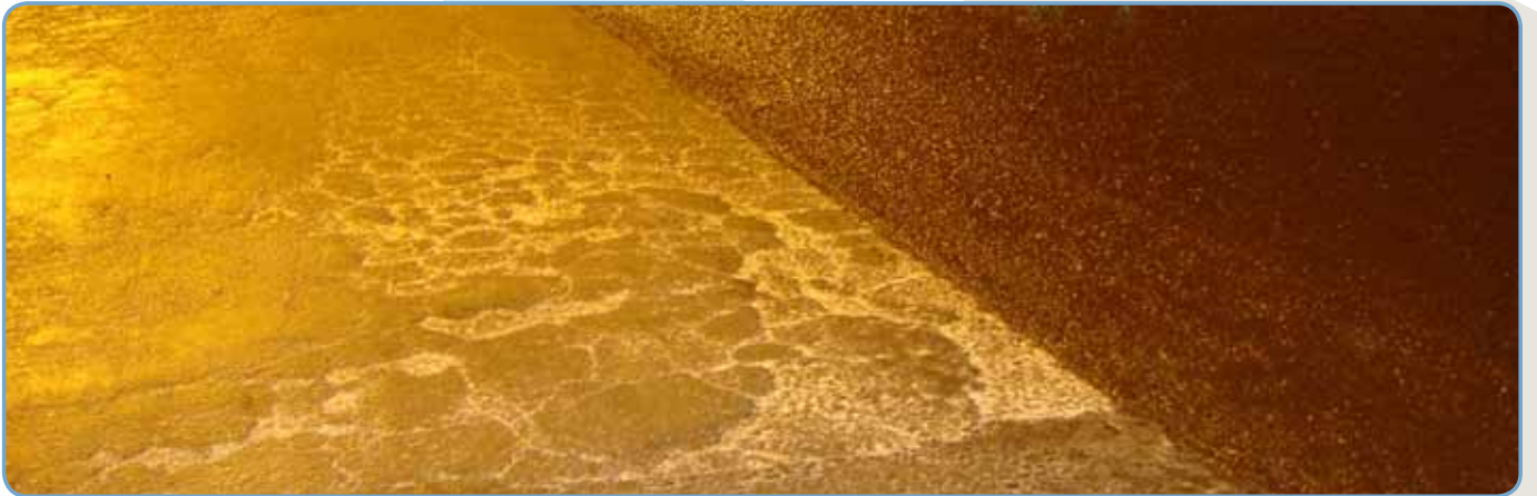
Antalya Büyük Şehir Belediyesi için, Cumhuriyet Caddesinde Gerçekleştirdiğimiz tanıtım çalışmasında ki yolun durumu.
